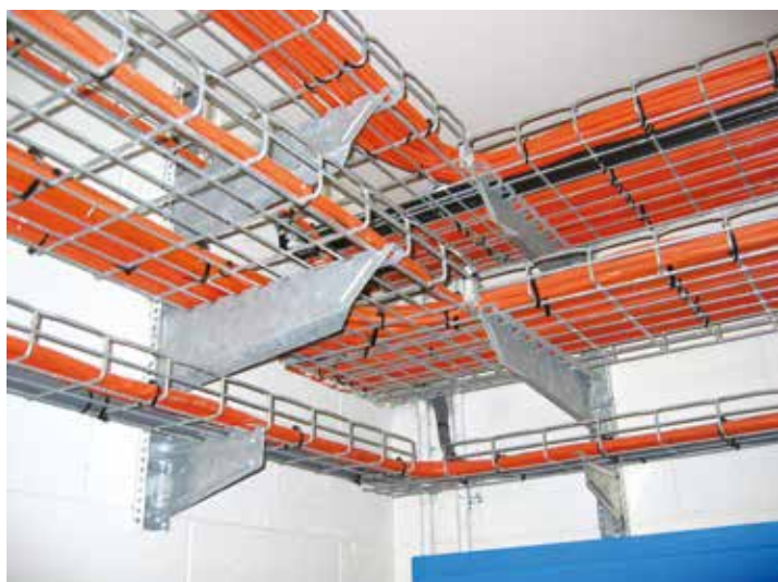
Ejemplo de espacio usado por sistema tradicional con cables.
